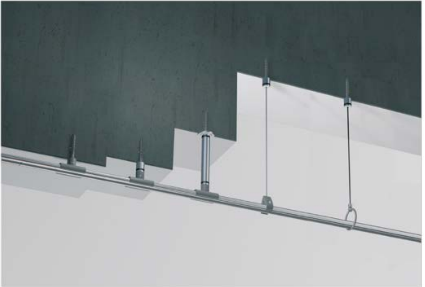
EINSPEISUNG POWER FEED
